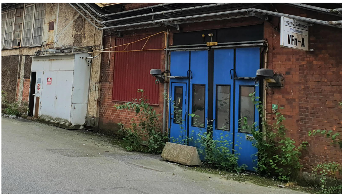
Figur 7. Skador på befintlig byggnad (Härden/R-fabriken) vid Rullaregatan och mossa intill fasaden som kan tyda på att området är återkommande blött (foto Tyréns 2021-07-09).
