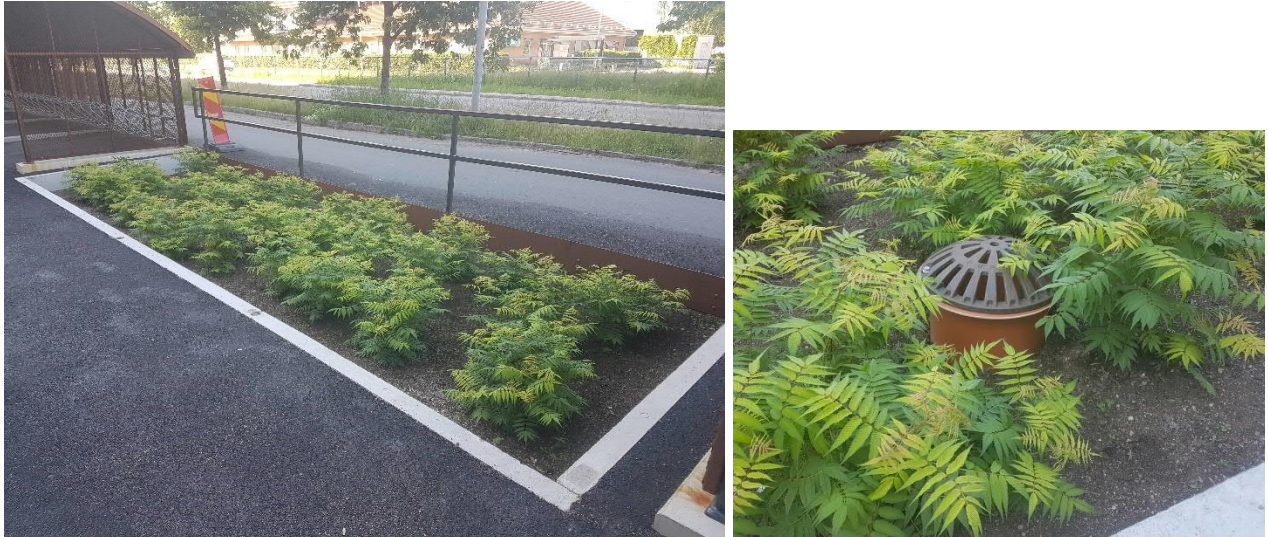
Figur 19. Exempel på utformning av en nedsänkt växtbädd med förhöjt bräddavlopp för ökad fördröjning och rening (Tyréns, 2020).
